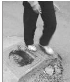
坏了的窨井盖
