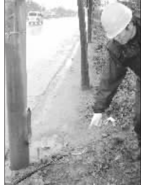
被破坏的路灯
