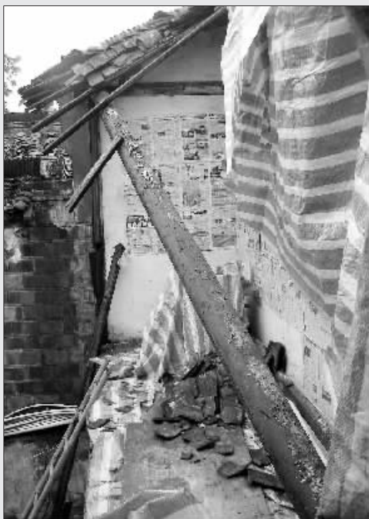
屋倒梁塌,古宅已经不起风雨
