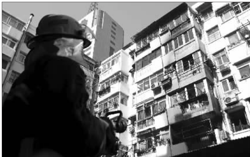
居民楼外墙被大火熏黑 快报记者 翁叶俊 摄
