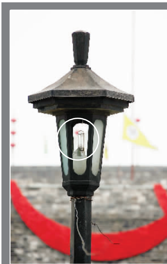
中华门城堡前广场上损坏的路灯。
