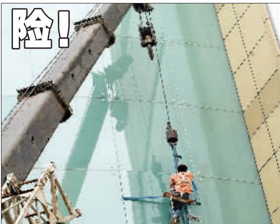
昨天,南京新街口某商场发生幕墙玻璃断裂的情况,如果玻璃落下来,后果将不堪设想。该商场动用起吊机,才排除险情。 快报记者 薛林 摄
