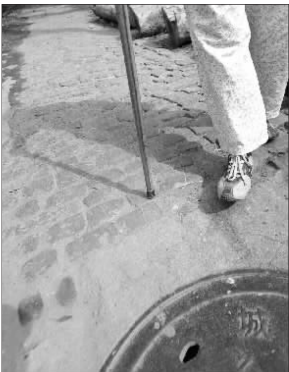
还剩150米的“坑人”路终于要翻修了 快报记者 施向辉 摄
