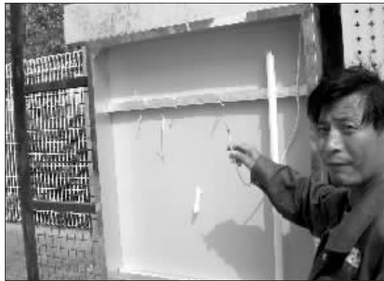
位于南京奥体中心南门的奥体大街上,灯箱广告牌毁损严重,28块广告牌有27块被破坏。由于广告牌当初是为了迎接十运会突击设立的,并没有经过审批,所以市区两级市容管理部门也没有好的解决办法。
