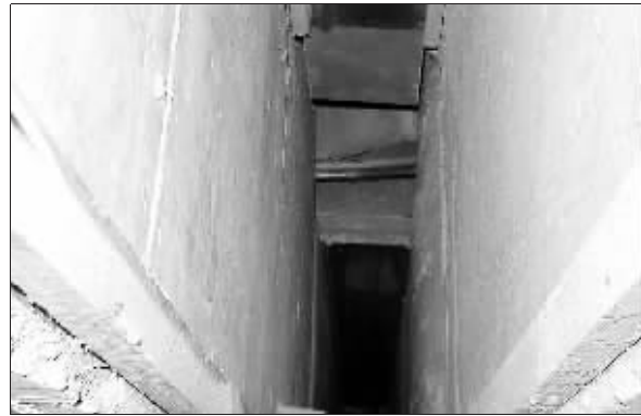
“未来城”一房屋存在缝隙
