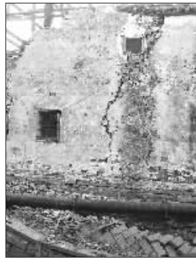
古民居墙体出现长长的裂缝
