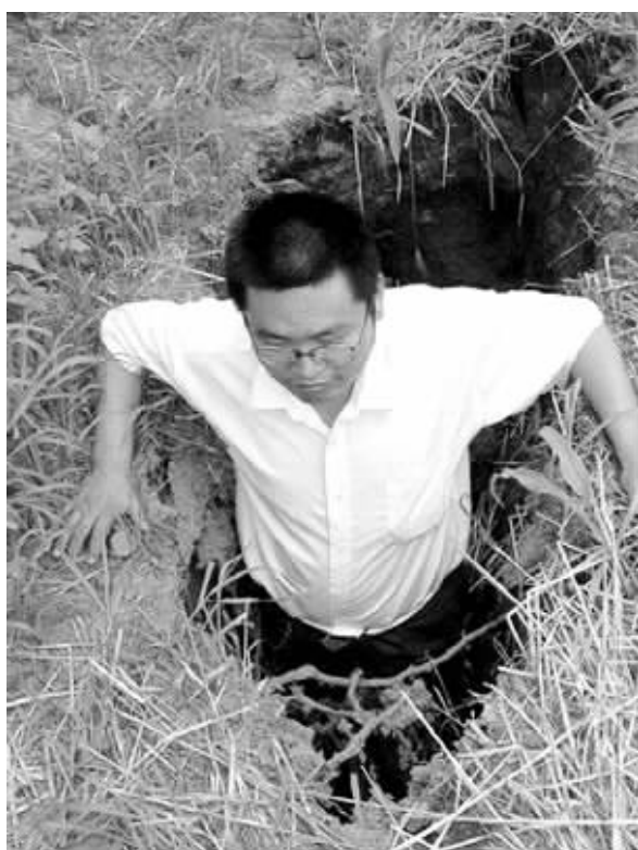
7月4日,河北省邢台市柏乡县在经过6月28日一场大雨后,地面形成一条长达8公里长的裂缝。
