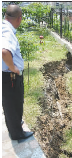
小区居民看着坍塌的地方担忧不已
