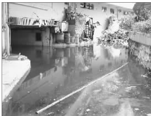
污水淹了地下车库 社区记者 赵丹丹 摄
