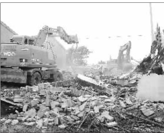
昨天,有关部门出动大型机械将七桥瓮周边违建房全部拆除 通讯员 赵国斌 摄
